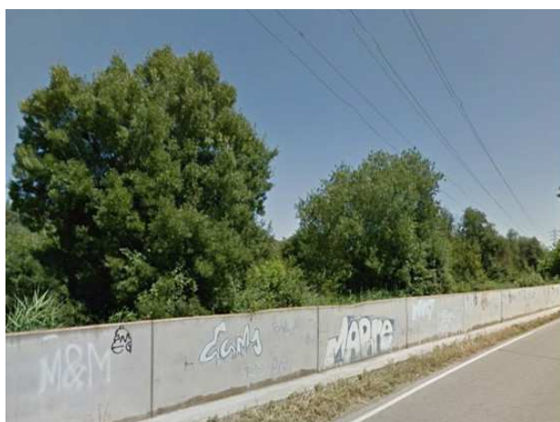
MUR EXISTENT ENTRE LA PRESA DEL CANAL DE SERÒS I LA CLAMOR DE LES CANALS
