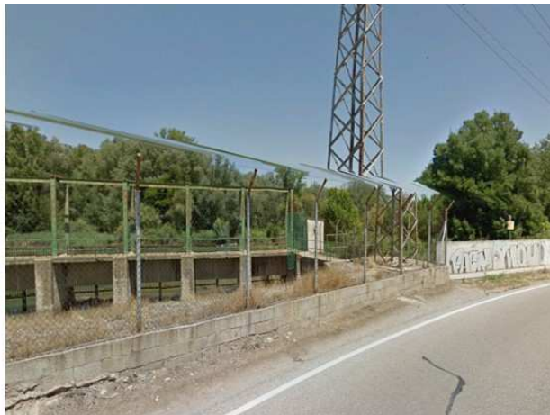
PUNT CRÍTIC ON NO HI HA CONTINUÏTAT ENTRE EL MUR DE DEFENSA I LA PRESA DEL CANAL DE SERÒS
