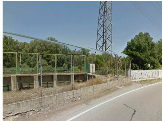
PUNT CRÍTIC ON NO HI HA CONTINUITAT ENTRE EL MUR DE DEFENSA I LA PRESA DEL CANAL DE SERÒS
